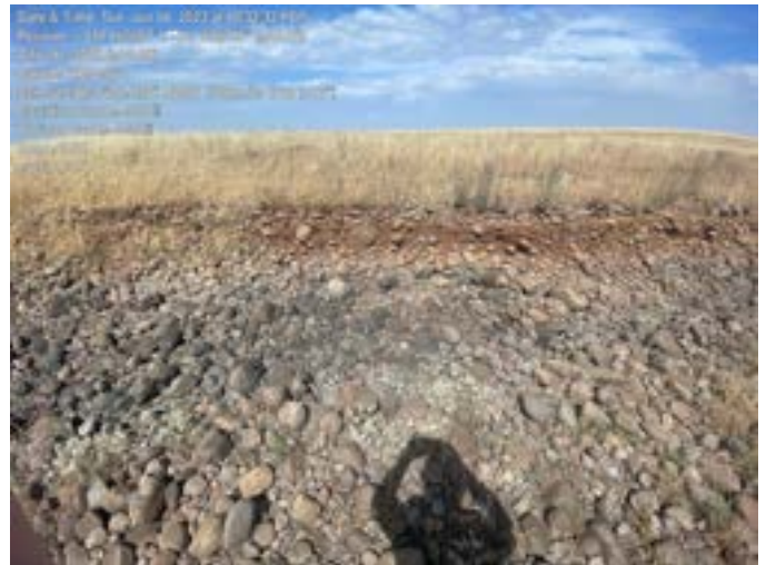
TH002788.JPG 64: erosion 3 ft
