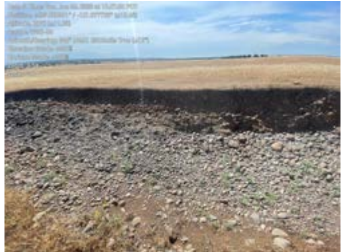
TH002782.JPG 58: scour 4 ft
