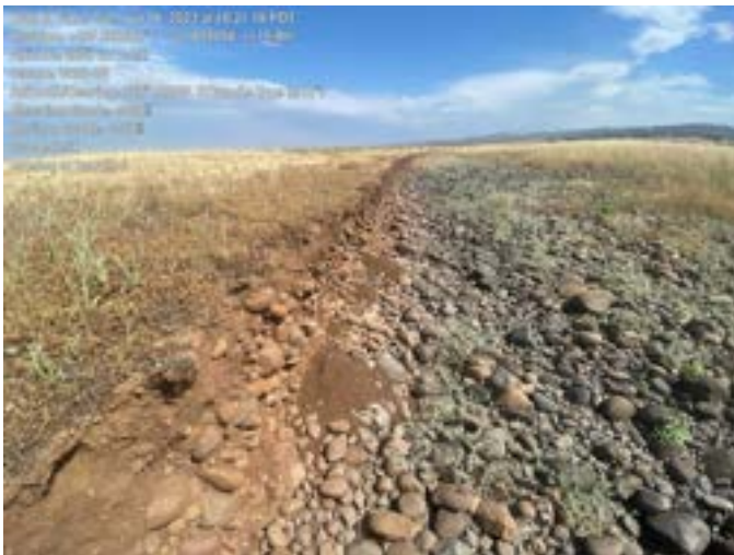
TH002777.JPG 53: erosion at bend 3 ft
