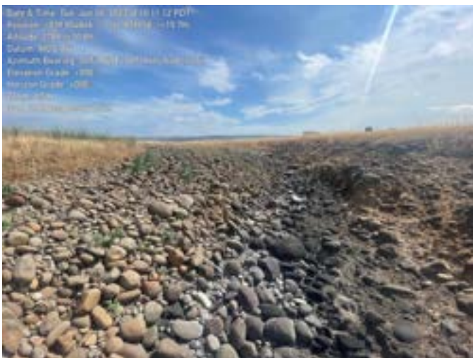
TH002759.JPG 35: from 10 ft deep scour hole
