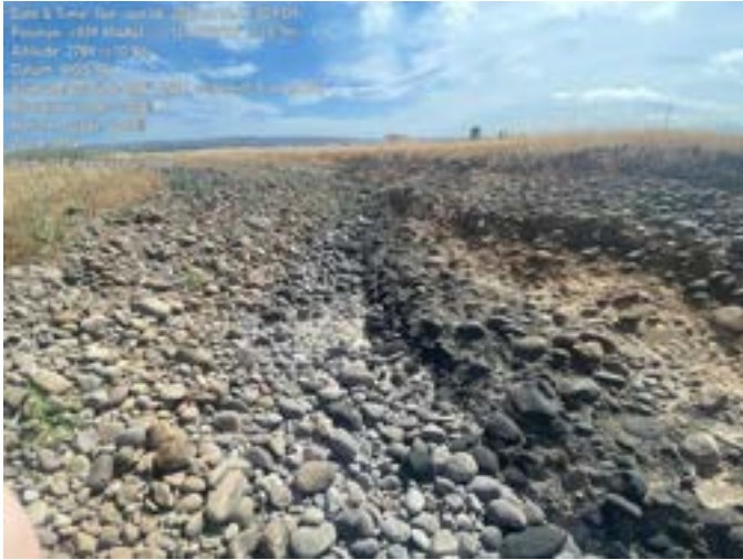
TH002761.JPG 37: from 10 ft deep scour hole
