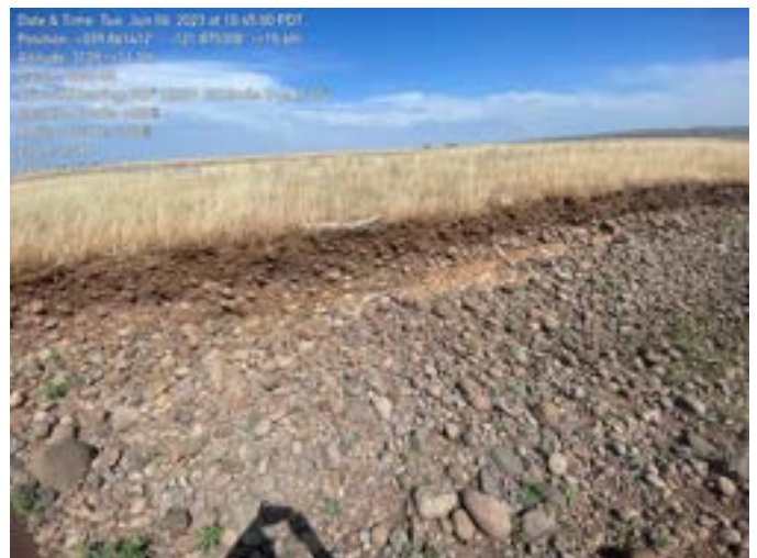
TH002808.JPG 84: bank erosion 3 ft chnl 15 wide
