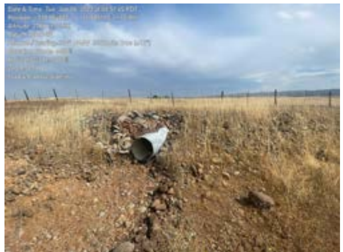
TH002736.JPG 12: road 4 ft above pipe inv
