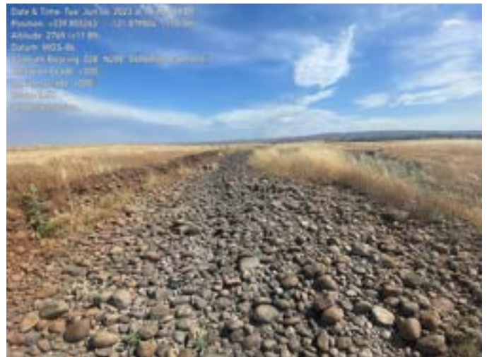
TH002768.JPG 44: 3 ft deep erosion
