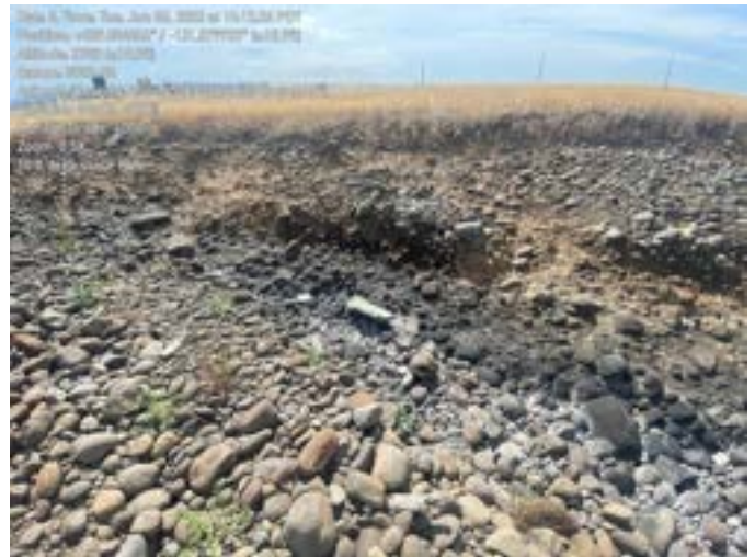
TH002764.JPG 40: 10 ft deep scour hole
