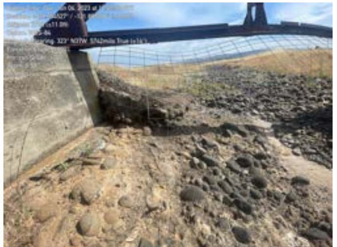
TH002750.JPG 26: bridge scour
