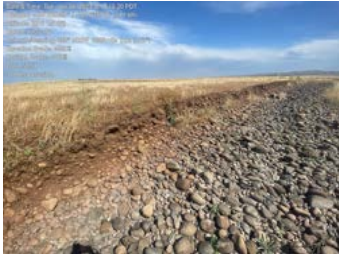
TH002767.JPG 43: 3 ft deep erosion
