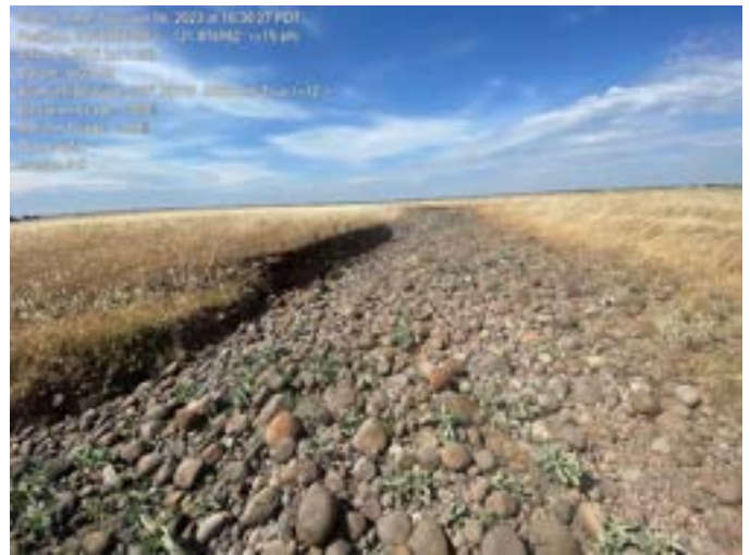
TH002786.JPG 62: erosion 3 ft
