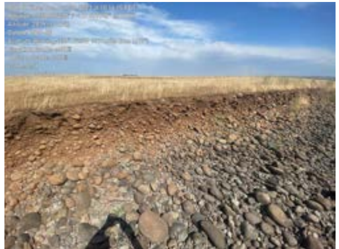
TH002770.JPG 46: 3 ft deep erosion
