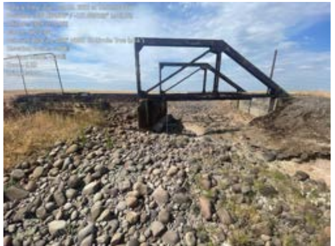
TH002752.JPG 28: bridge scour
