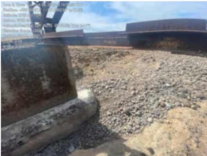
TH002751.JPG 27: bridge scour
