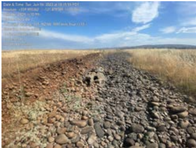
TH002769.JPG 45: 3 ft deep erosion
