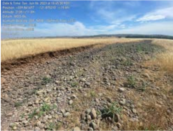
TH002809.JPG 85: bank erosion 3 ft chnl 20 wide
