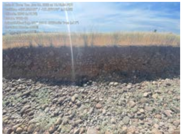
TH002772.JPG 48: 5 ft deep erosion
