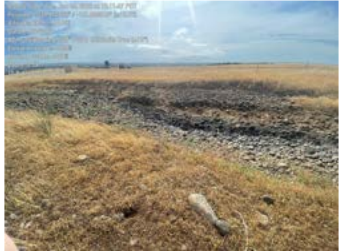
TH002762.JPG 38: 10 ft deep scour hole
