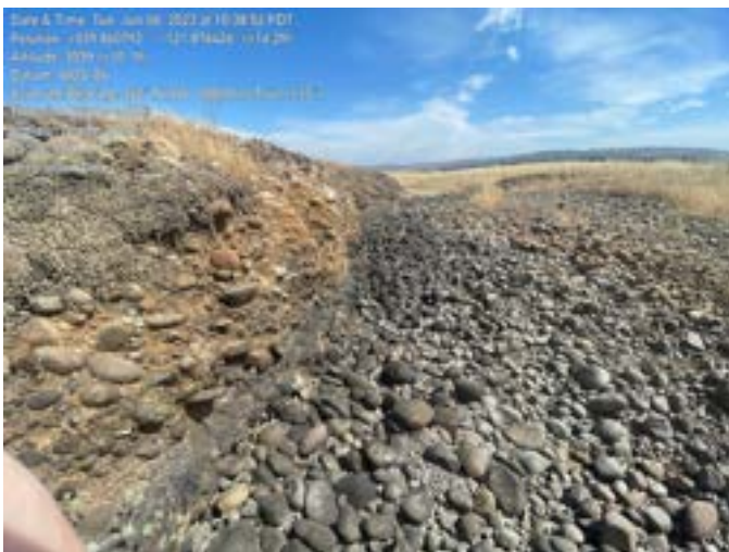
TH002801.JPG 77: deep scour hole
