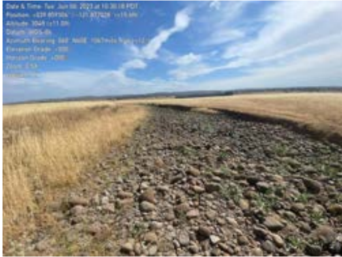
TH002785.JPG 61: erosion 3 ft
