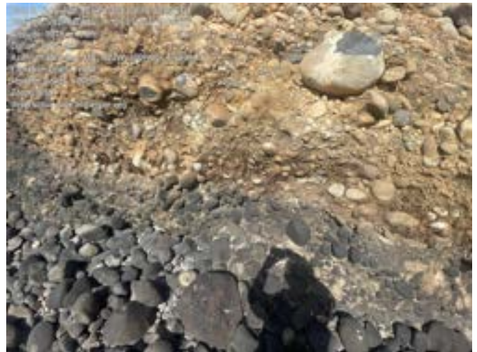
TH002800.JPG 76: deep scour hole old algae veg
