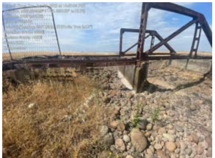
TH002754.JPG 30: bridge scour
