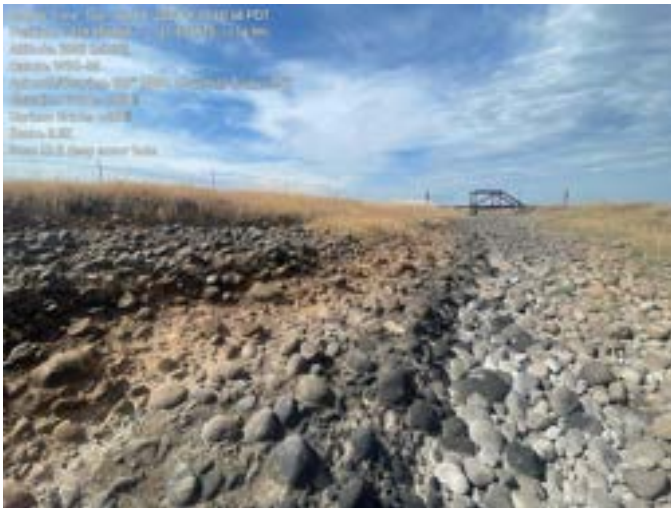
TH002757.JPG 33: from 10 ft deep scour hole
