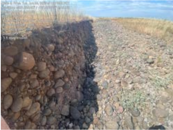
TH002773.JPG 49: 5 ft deep erosion
