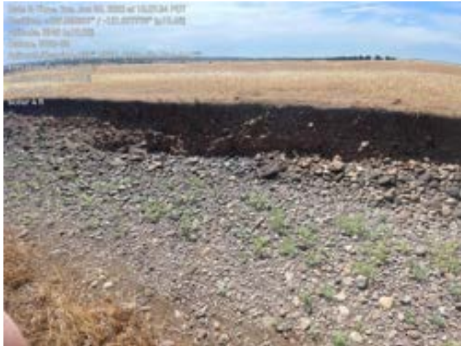
TH002781.JPG 57: scour 4 ft
