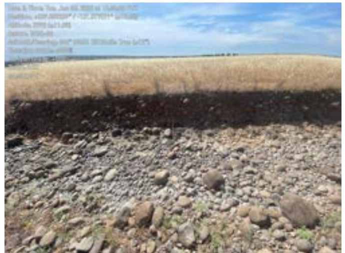
TH002784.JPG 60: erosion 3 ft
