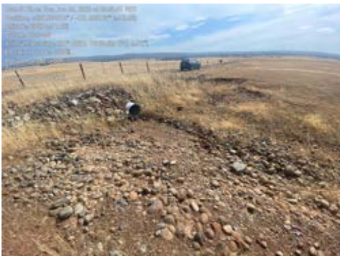
TH002735.JPG 11: scour hole 7 x 10 x 6
