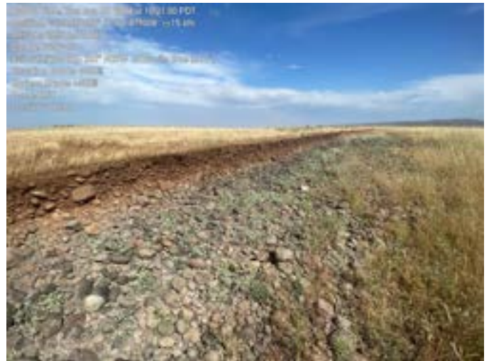
TH002776.JPG 52: erosion at bend
