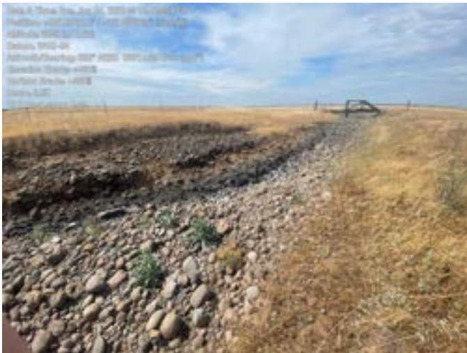
TH002763.JPG 39: 10 ft deep scour hole
