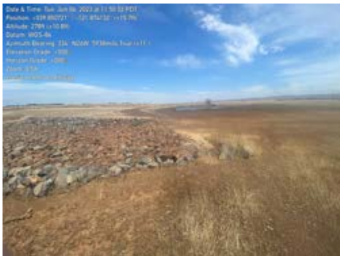
TH002837.JPG 113: erosion control spillway
