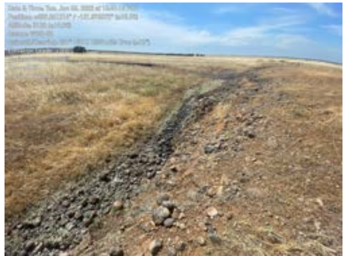
TH002804.JPG 80: erosion of bank
