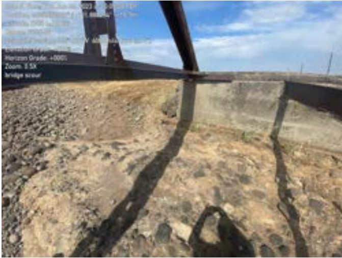
TH002749.JPG 25: bridge scour
